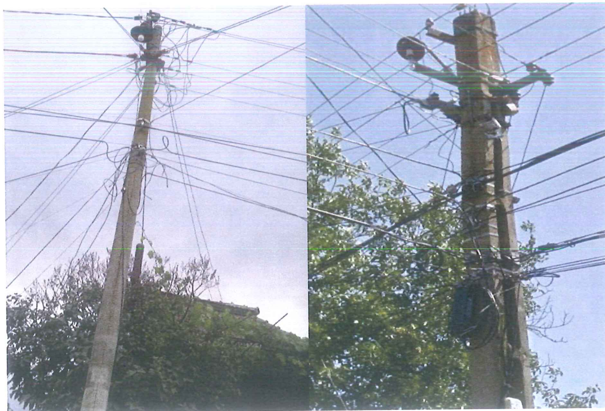
Corpuri de iluminat neconforme, fără dispersor
