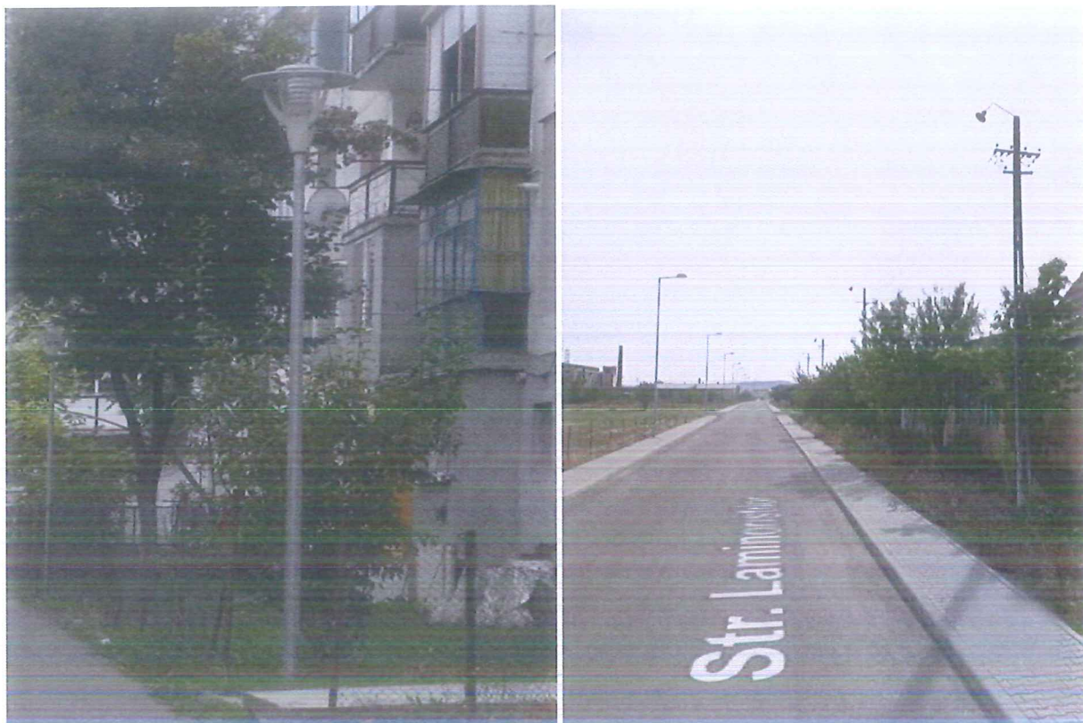
Corp de iluminat pietonal cu lampă CFL- Lampi Noris mai vechi de 40 de ani
