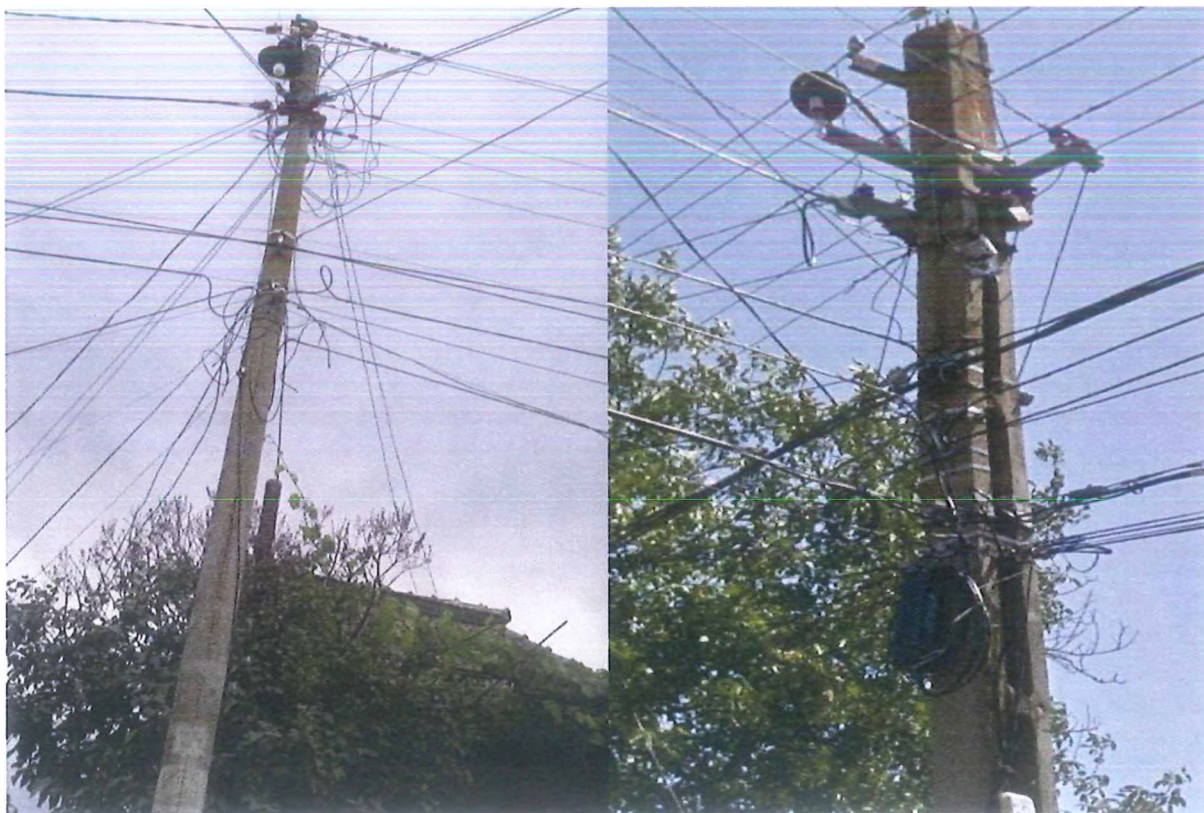
Corpuri de iluminat neconforme, fără dispersor
