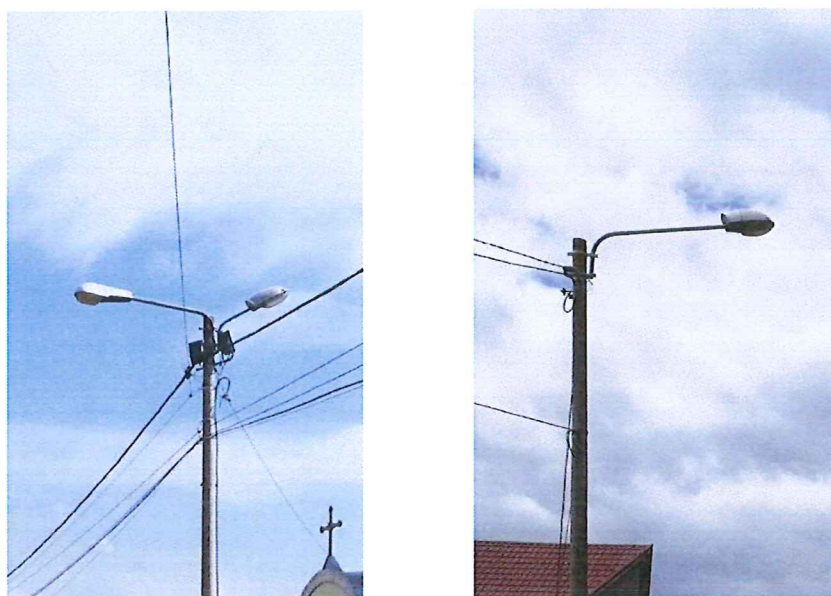
Foto nr. 3 – Situație Existentă a Aparatelor de Iluminat – strada Nicolae Titulescu și strada Erou Martir Matîș Petru Dorin
